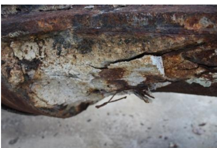
Figura 28: Detalle restos de hormigón.
